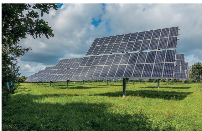
Placas de energia solar.
